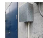
ボイラーや屋外設備等
