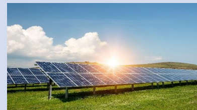
太陽光発電の架台
