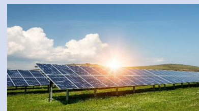
太陽光発電の架台
