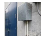
ボイラーや屋外設備等
